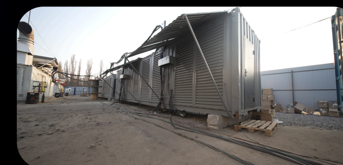
Приволжский Мощность: 17 МВт
