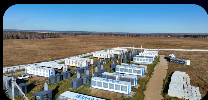
Сибирский Мощность: 64 МВт
