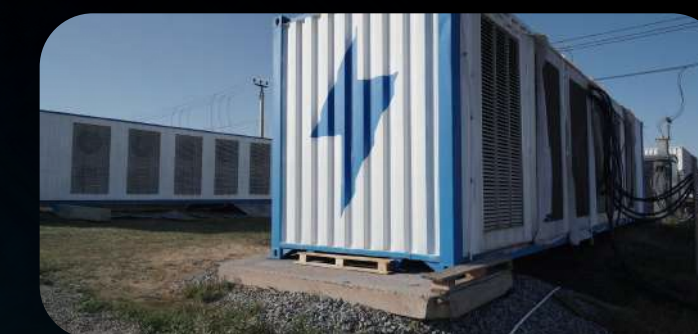
Приволжский Мощность: 17 МВт
