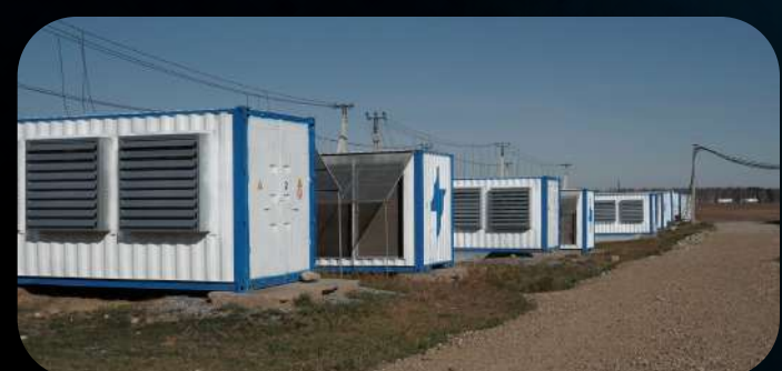
Центральный Мощность: 19 МВт
