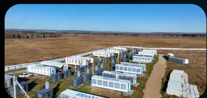
Сибирский Мощность: 64 МВт
